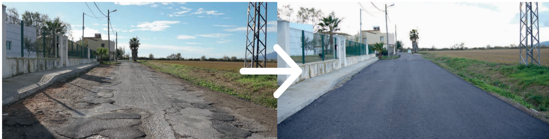
Abans i després dels treballs de fresat i pavimentació al carrer Aldover
